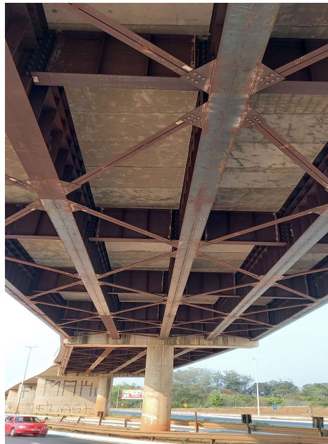
Figura 9 - Longarinas oxidadas do viaduto do BRT Sul da DF-065
