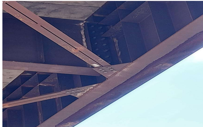
Figura 11 - Corrosão no viaduto do BRT do Catetinho
