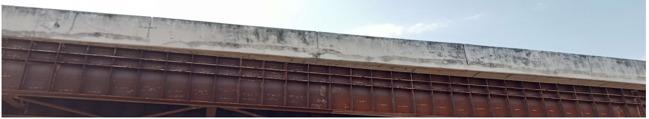
Figura 8 - Longarinas oxidadas do viaduto do BRT Sul da DF-065
