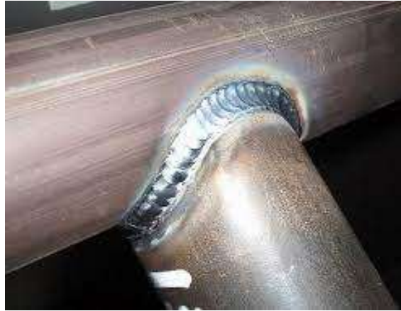
Figura 4 - Estrutura soldada com solda industrial.
