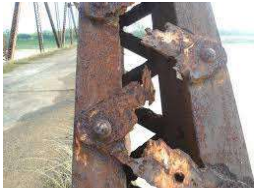
Figura 2 - Corrosão em Estrutura Metálica
