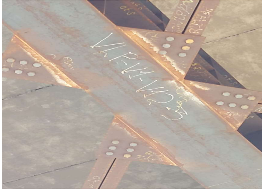
Figura 10 - Oxidação nos pinos da longarina do viaduto do BRT Sul da DF-065
