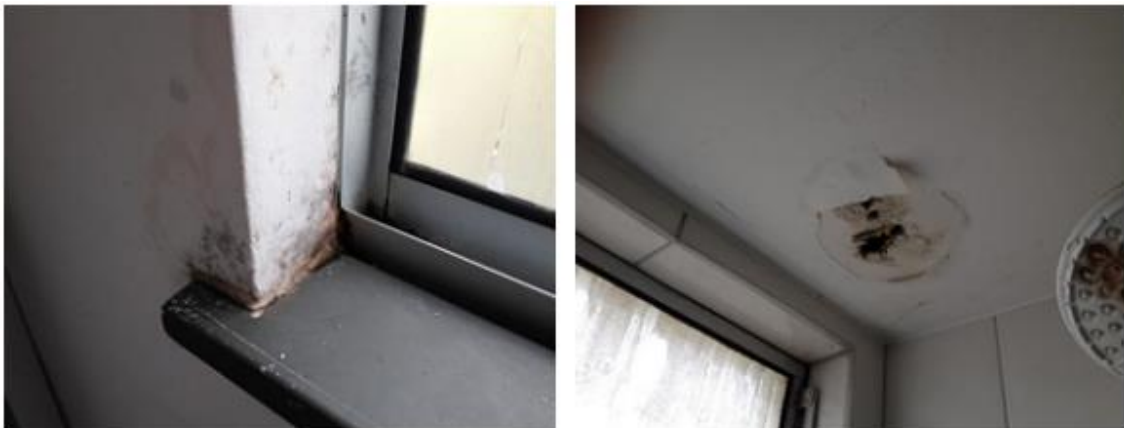
Figura 01: Problemas nas Unidades Habitacionais do PMCMV
