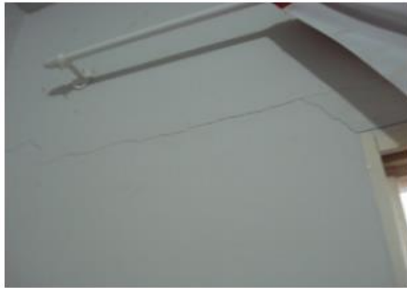
Figura 04: Problemas nas Unidades Habitacionais do PMCMV
