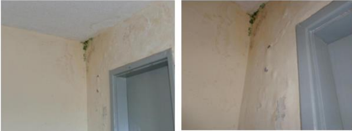
Figura 02: Problemas nas Unidades Habitacionais do PMCMV.
