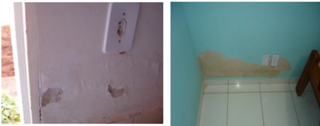
Figura 03: Problemas nas Unidades Habitacionais do PMCMV
