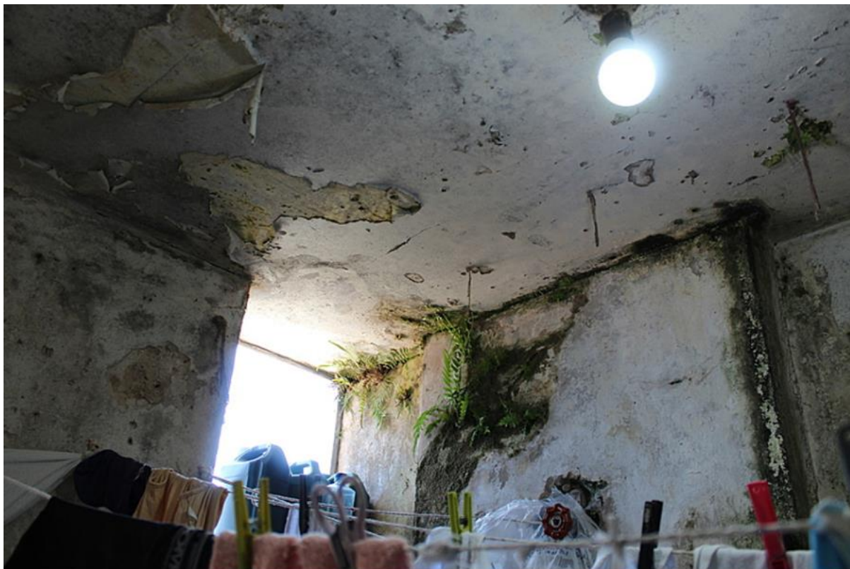
Figura 4-Condições precárias do prédio onde vivem as mulheres presas no CPP Butantã
