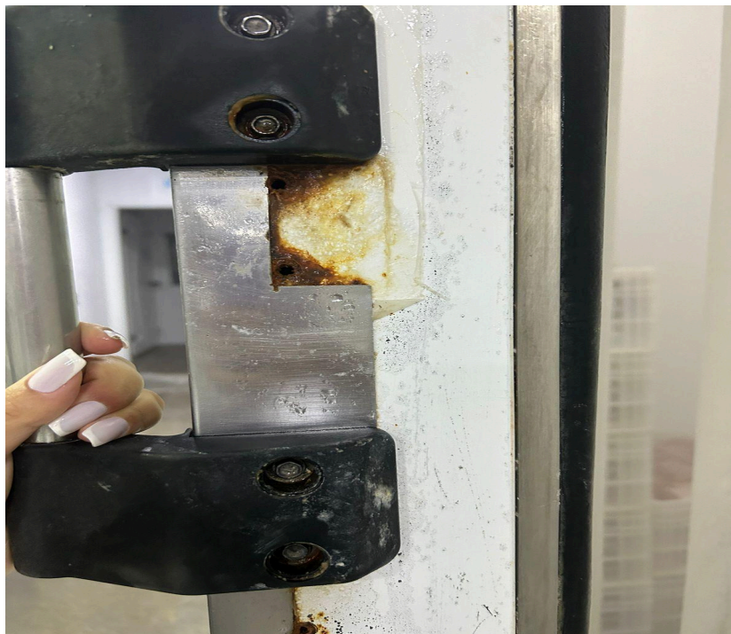
Figura 5. Manipulador sem EPI e porta da câmara fria com ferrugem.
